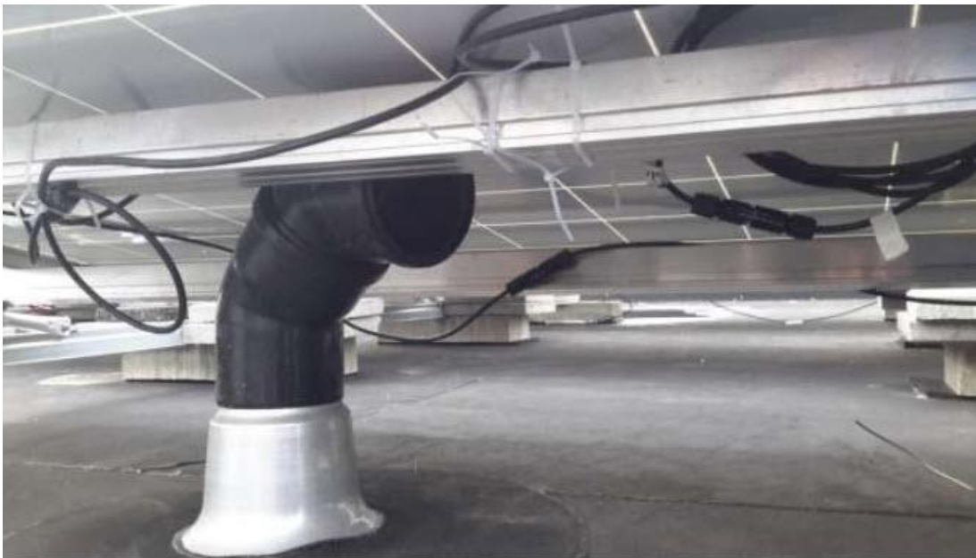
Paneel te strak tegen afvoer aan
