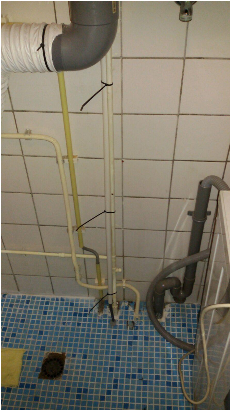
Kabels vast aan warm waterleiding. Afvoer geraakt dus bij douchen loopt water in de meterkast.
