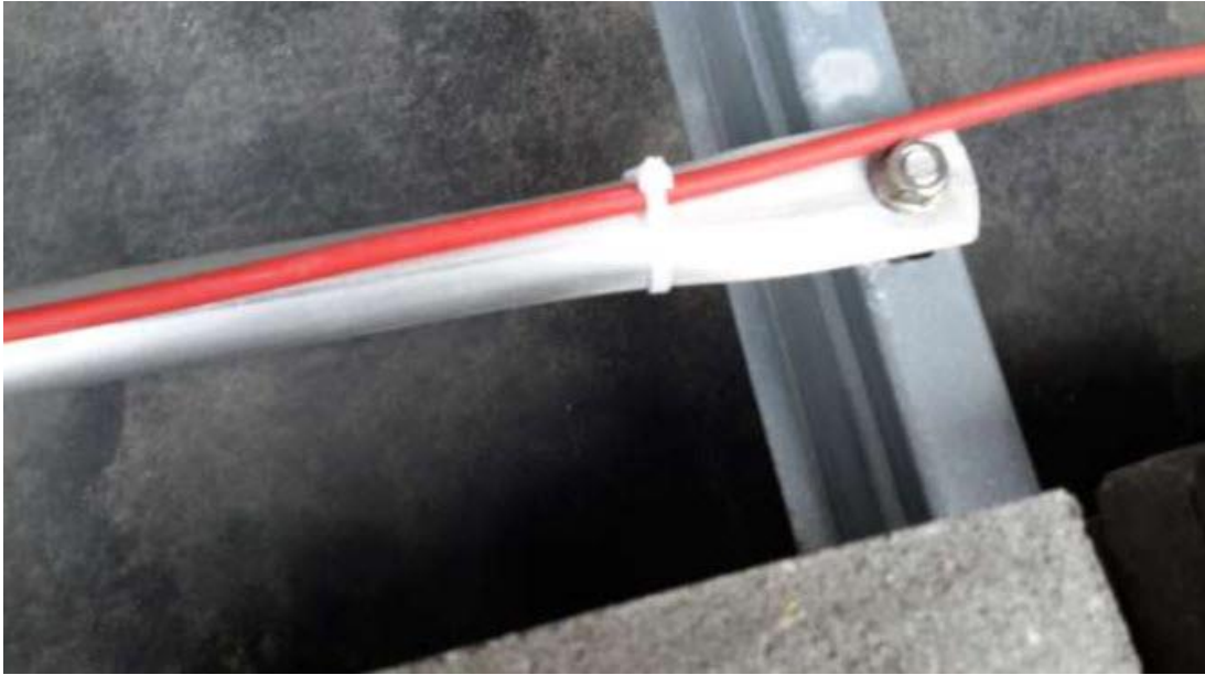
Tiewraps niet bedoeld voor buiten
