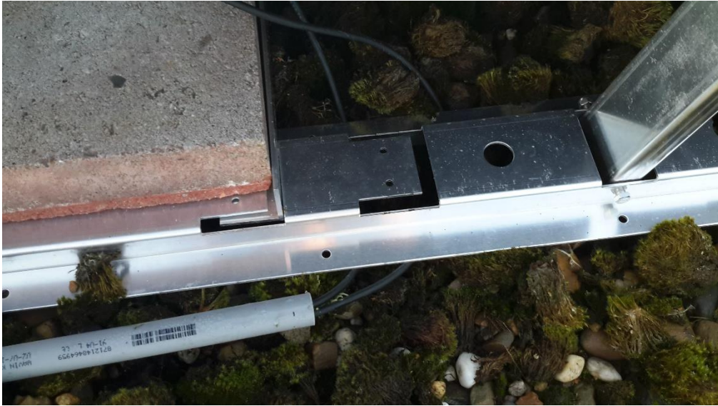
Kabels tussen constructie door, kans op insnijden
