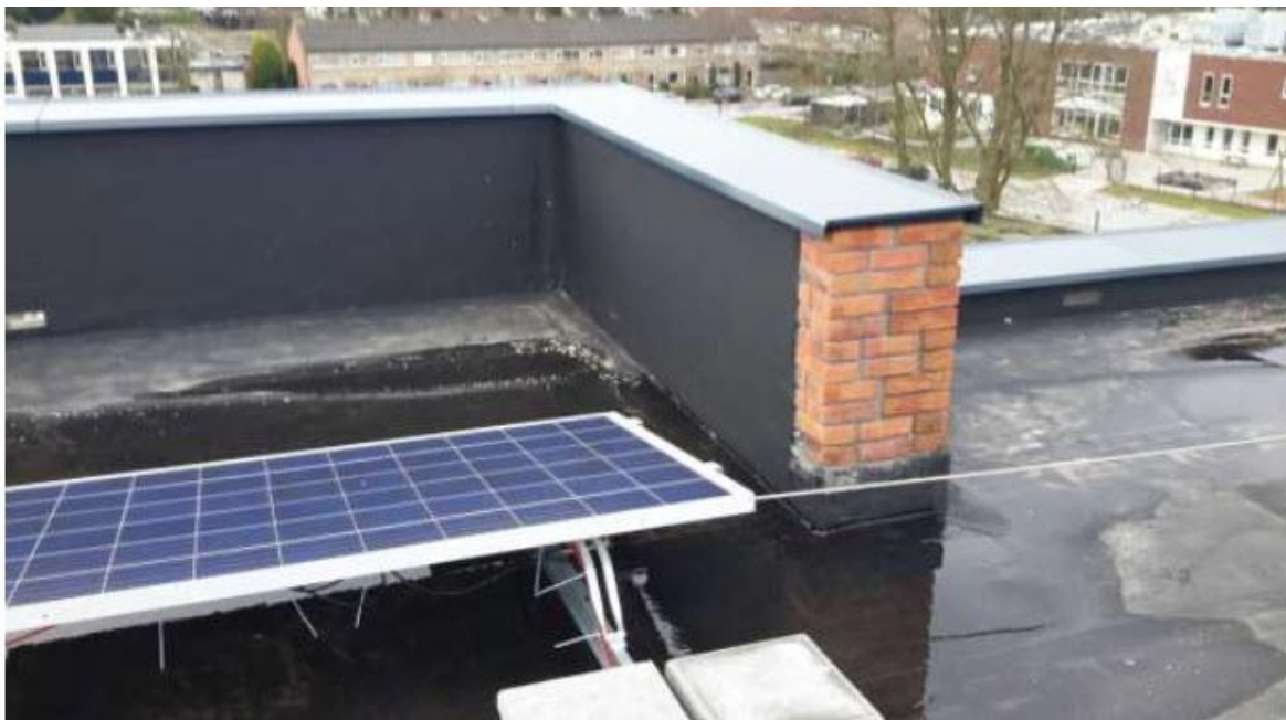
Paneel in schaduw en over valbeveiligingslijn heen
