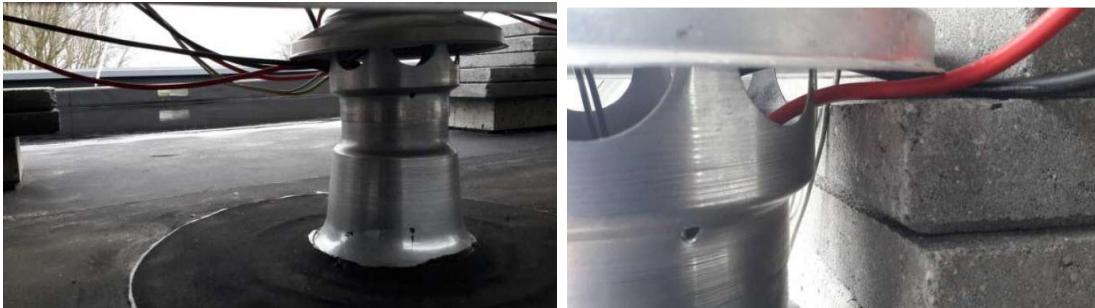
Kabels loshangend, niet beschermd tegen insnijden
