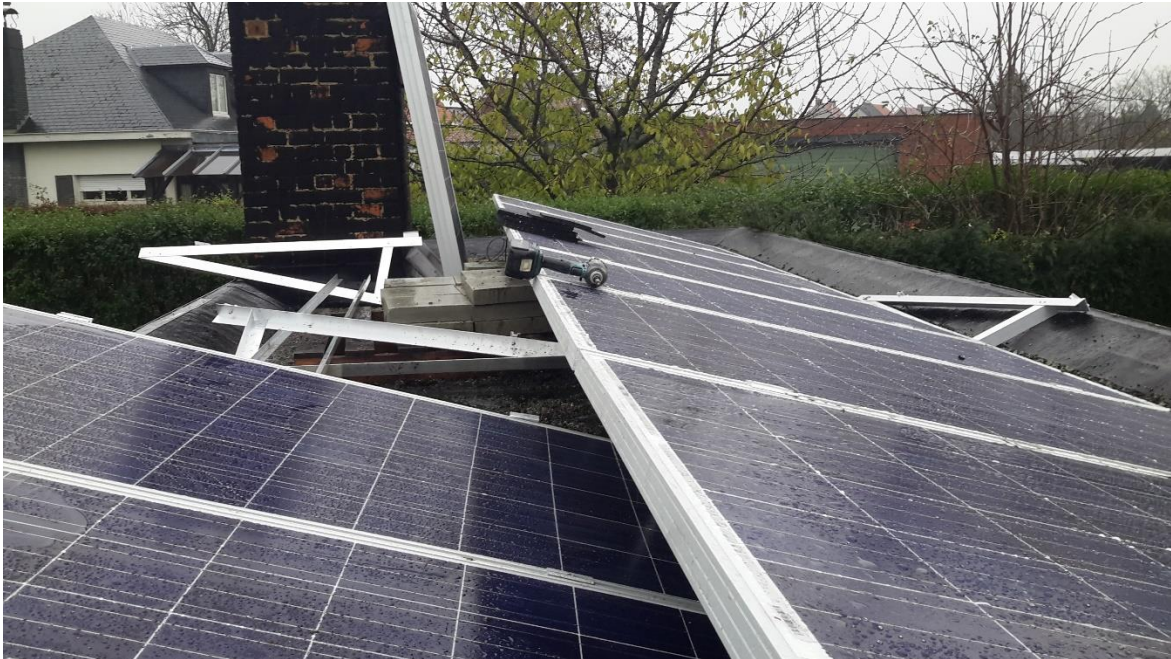
Panelen over elkaar gelegd met inferieur constructiemateriaal
